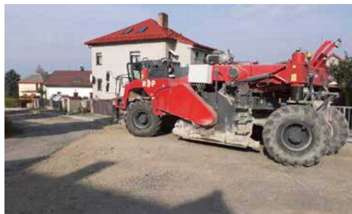
V Zeleného ulici došlo k rozfrézování, přerovnání a zahutnění povrchu. Foto: Přemysl Tonar
