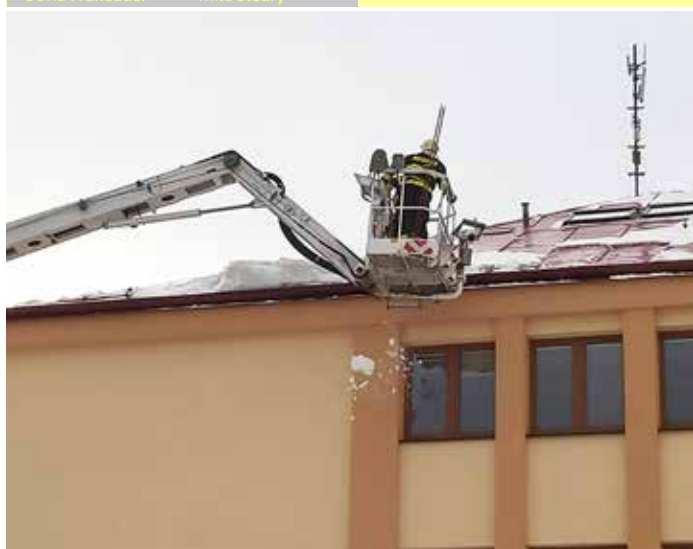
Počátkem února komplikovaly vstup do budovy školy uvolněné konstrukce na zachycování sněhu. S odstraněním pomáhali chotěbořští hasiči. Foto: ZŠ
